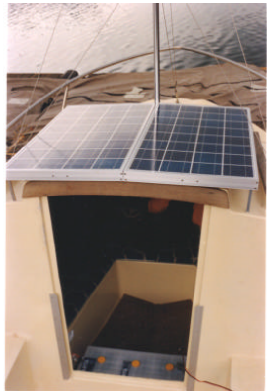
Detalle de la batería
