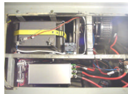
Batería 12 V - Motor Variador de velocidad
